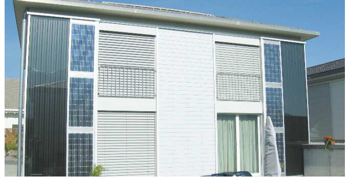
Solaranlage an Fassade
