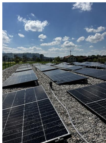
Foto: Solarstromanlage Freibad Ostermundigen
